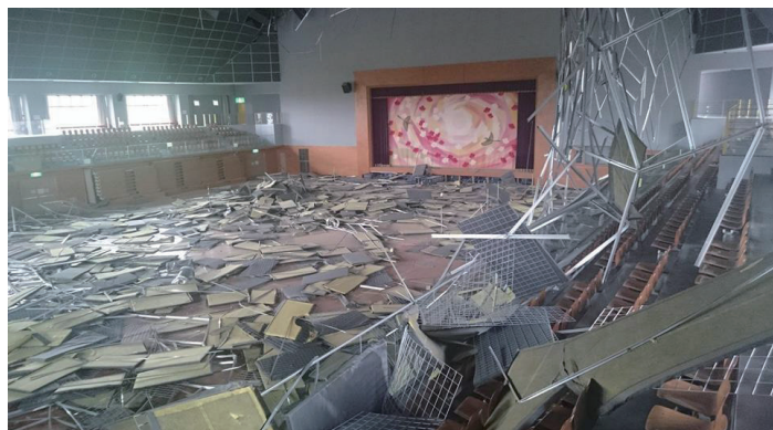
写真2 「本震」後のメインアリーナの被害 (益城町提供)
