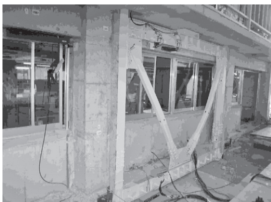
写真13 補強試験体の破壊状況(新詳細)
