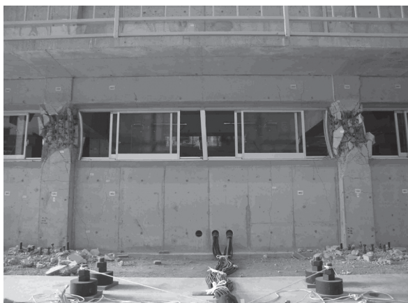
写真11 既存RC試験体の破壊状況(廊下側)
