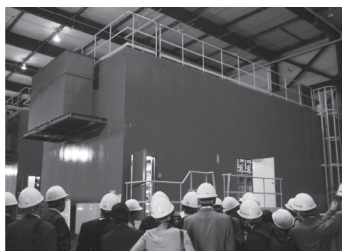
写真4 施設見学の様子（ガスエンジン）
