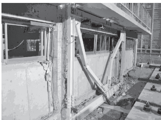
写真14 補強試験体の破壊状況(既往詳細)
