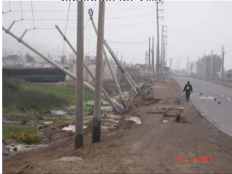
Detalles de los postes caídos, niveles altos de napa freática: zona denominada pantanos de Villa
