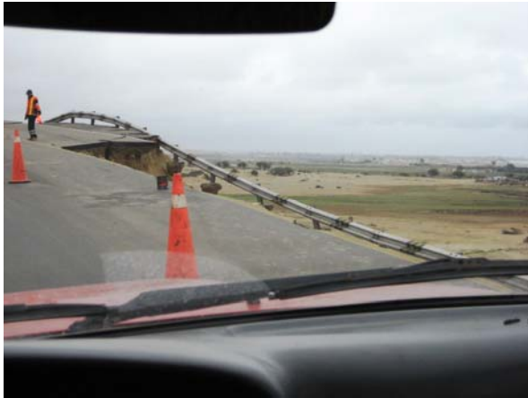
チンチャの手前で幹線道路が壊れているところ
