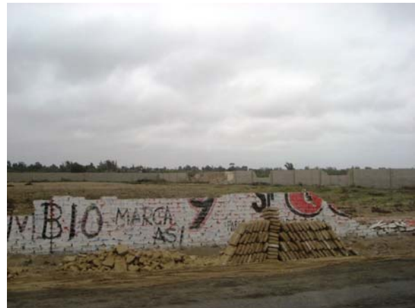
縦枠だけで上の横枠がない塀（奥）の破壊
