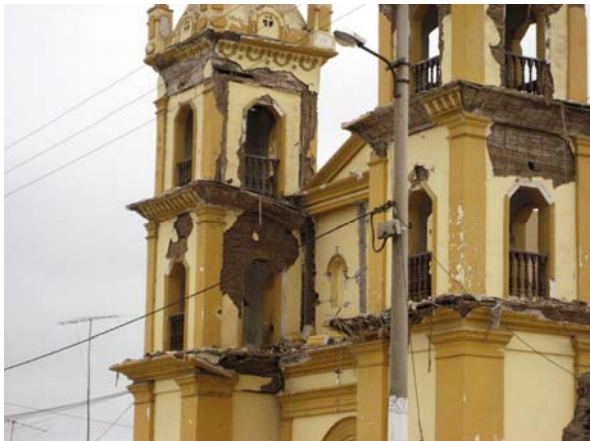
キンチャ構造の教会の塔の被害
