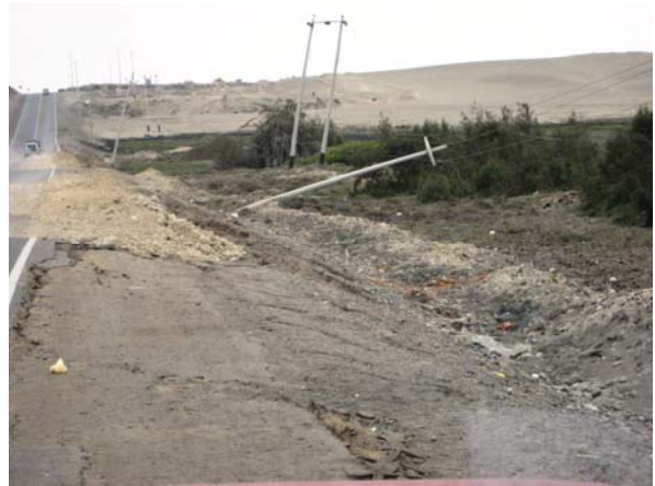
チンチャの先では道路脇の電柱も傾いている
