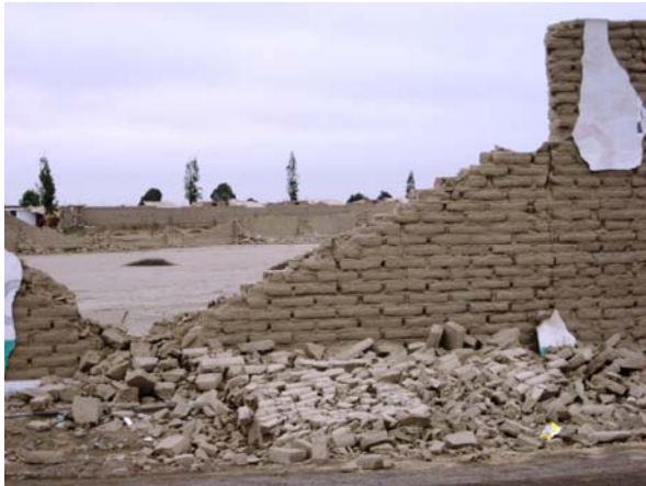
組積壁の塀の破壊はたくさん見られる
