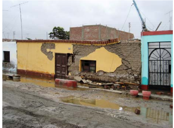
液状化によるアドベ造の不同沈下
