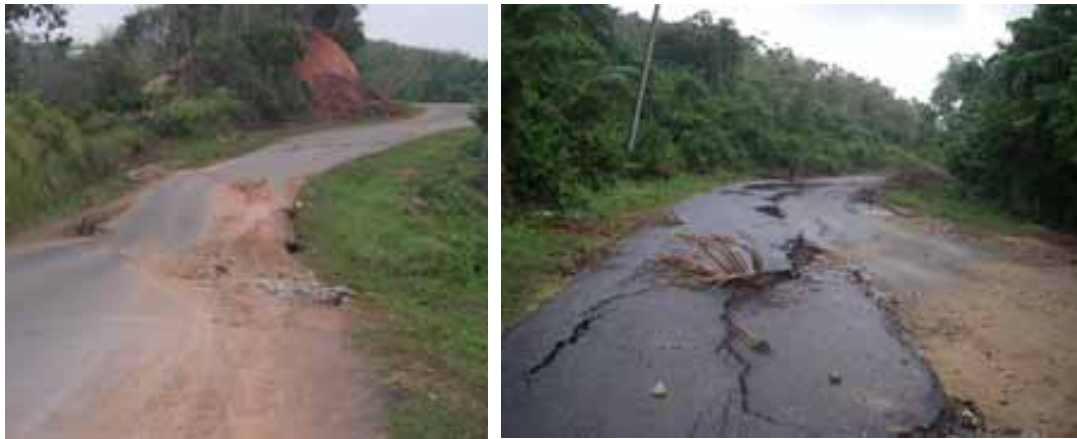
写真7 斜面と盛土の崩壊による道路被害
