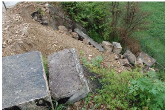
写真-146 散在する石造アーチ主構部材
