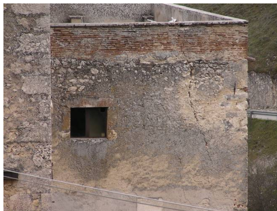
写真-126 バルコニーのひび割れ
