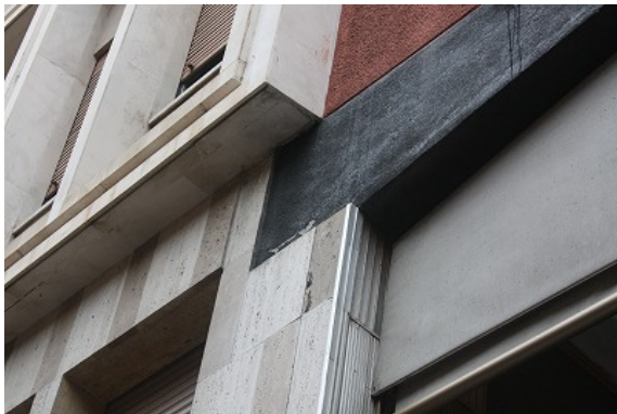
写真-41 梁のせん断ひび割れ (2)
