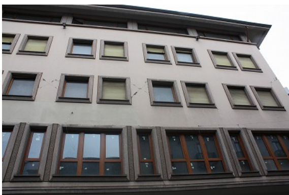
写真-45 柱のせん断ひび割れ(4)
