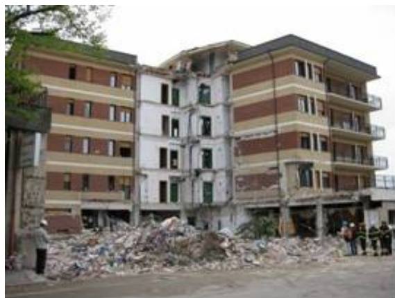
写真-69 学生寮の崩壊
