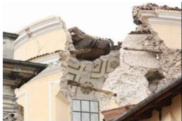
写真-20 崩壊したドーム
