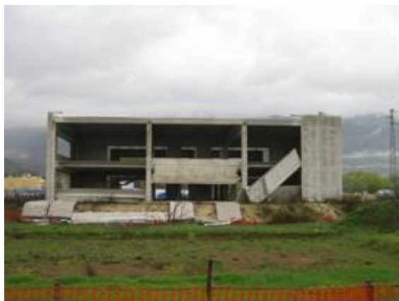
写真-85 建設中のPC造工場の被害
