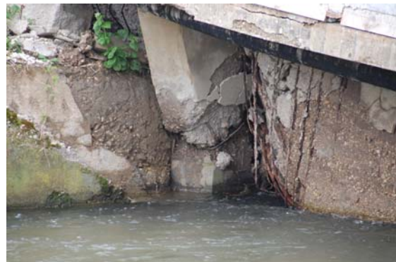
写真-136 パイルベント橋脚の損傷
