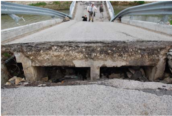
写真-131 3径間連続橋の落橋 (Fossa 駅近く)
