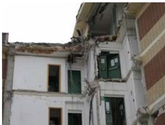
写真-70 増築部分の梁鉄筋が露出
