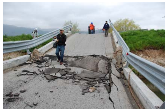
写真-134 パンチングシェアにより 床版上に突出した橋脚頭部
