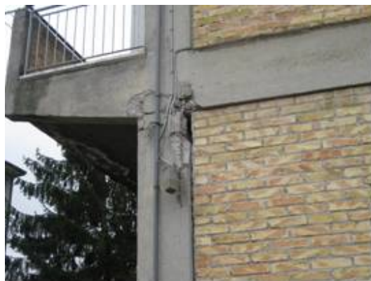
写真-100 柱頭部の接合部にひび割れ
