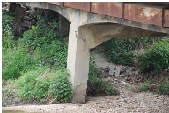
写真-142 RC ラーメン橋脚の損傷
