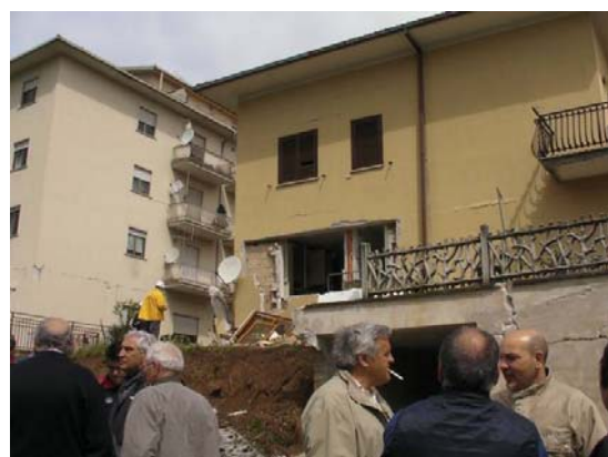
写真-120 盛土崩壊の様子
