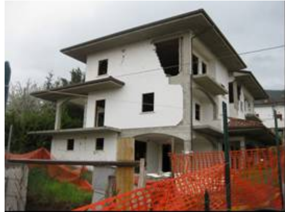
写真-78 RC住宅の組積壁せん断破壊と 仕上剥落
