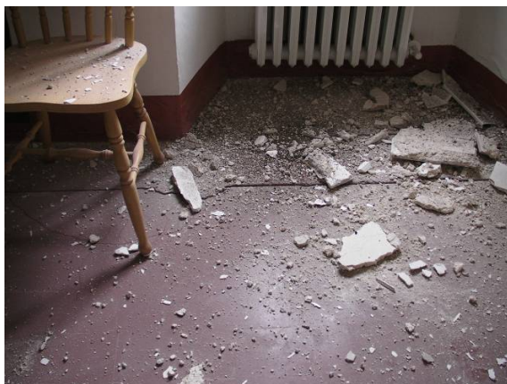
写真-125 床のひび割れ
