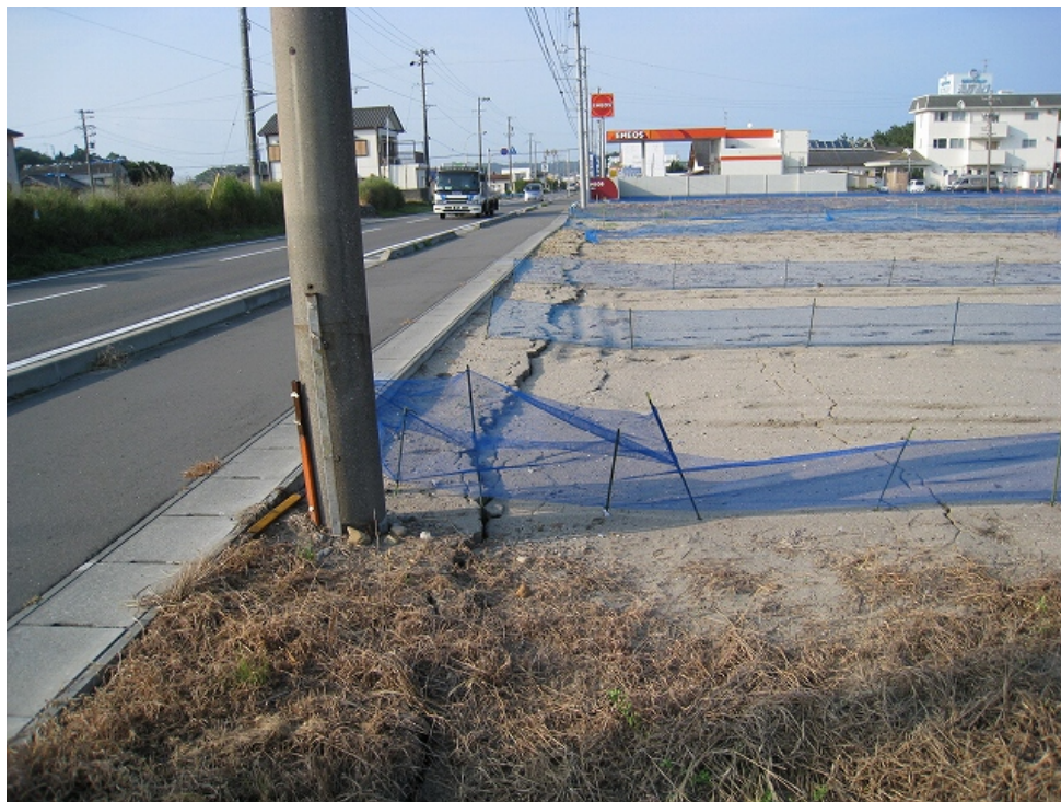
写真9 道路に沿う亀裂、この亀裂の右側（東側）に噴砂が多数発生した。
