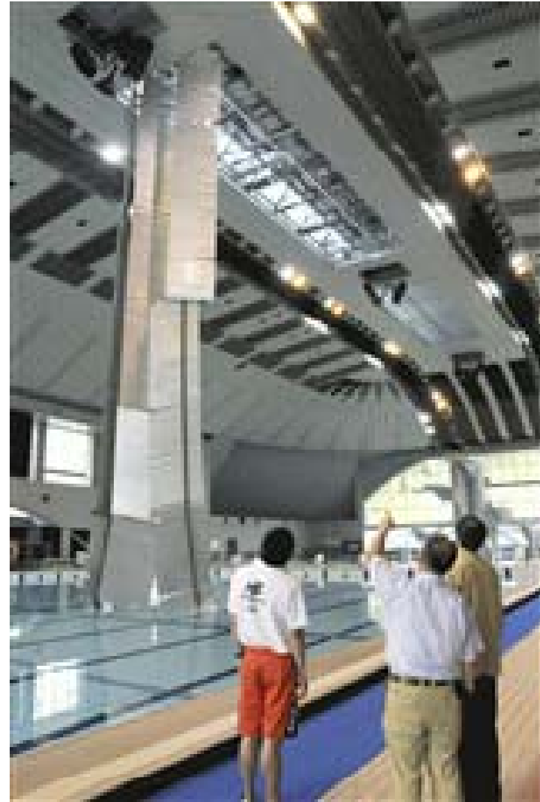
天井パネルの落下
