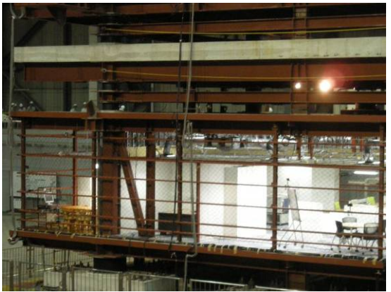
写真 4 室内の損傷状況（RC 建物）2
