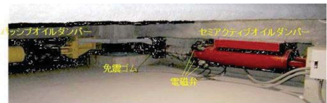
図4 オイルダンパー設置状況
