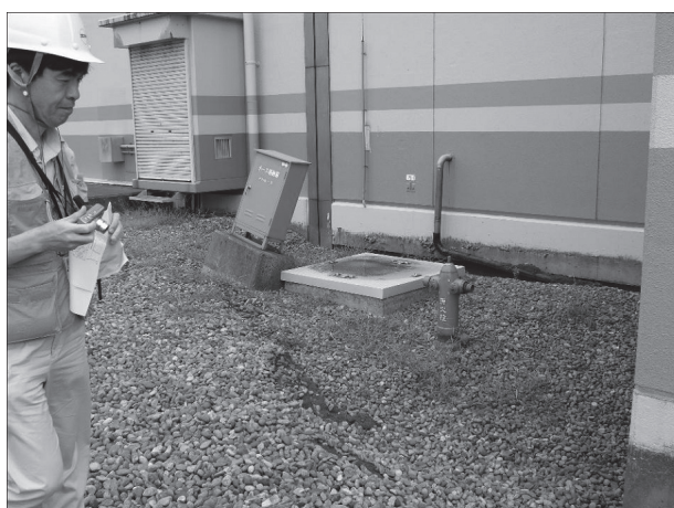
写真4 激しい震動により地盤が大きく揺り込み沈下した
