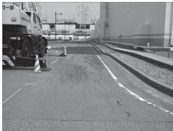
写真9 表層地盤の不等沈下により道路がうねっている
