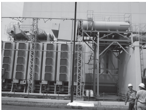
写真10 杭基礎を有しないCクラスの設備は、傾斜などの被害を引き起こした。
