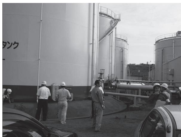
写真16 タンクとパイプの接合部は、応力集中により被害が発生した
