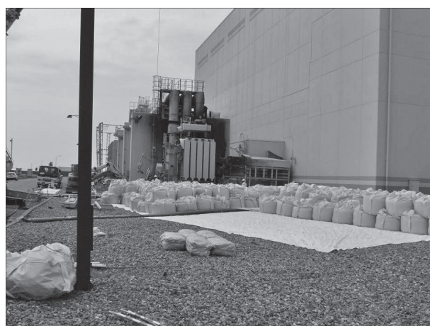
写真5 変圧器よりの油もれを防ぐトンパック堤
