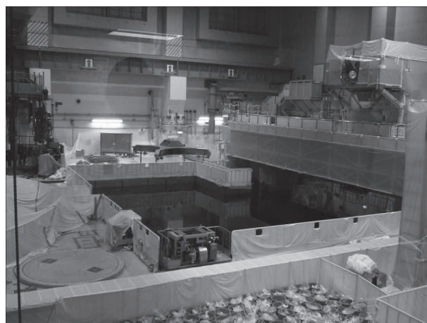
写真14 使用済み燃料プールの液体がスロッシングして越流した
