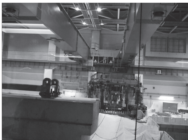
写真13 室内クレーンの支承部に応力集中によると思われる被害が発生した
