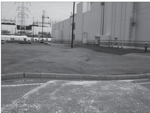
写真8 地盤沈下により地中の洞道が浮き上がったように見える
