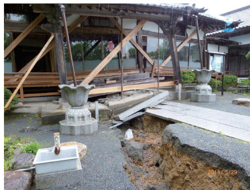
写真1 2011年福島県浜通り地震で出現した地表地震断層と、その直上の木造建物の被害 1)
