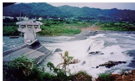
写真2 稗豊橋の桁の落下および河床の段差出現
