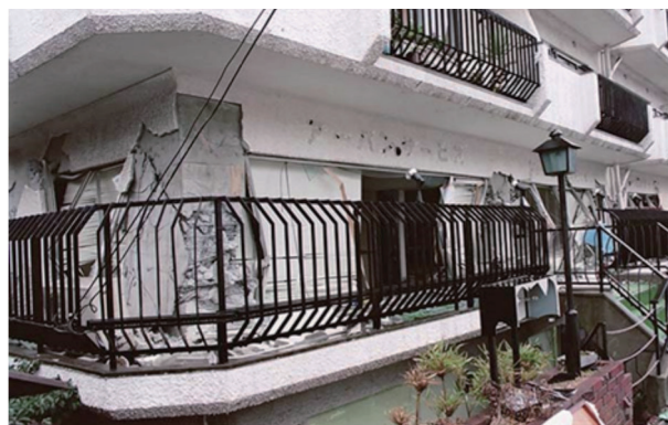
兵庫県南部地震でせん断破壊を生じた建物(1995年1月22日撮影、芦屋市内)。講義・研究室の実験で教えを受けてはいたが、この現地調査で実建物のせん断破壊を改めて認識した。
