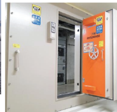
水密扉：重要機器室への浸水を防止（約60箇所）
