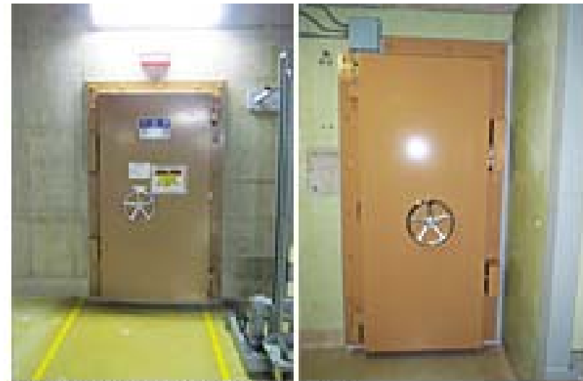
2号機建物内に設置した水密扉
