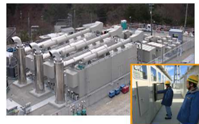
大容量電源装置を用いた 電源確保訓練
