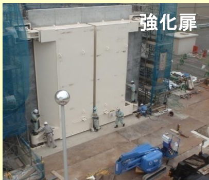
原子炉建屋大物搬入口 (外側)強化扉設置状況(3号機の例)
