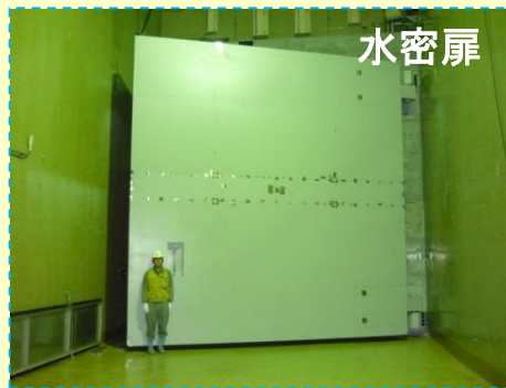
原子炉建屋大物搬入口 (内部)水密扉設置状況(3号機の例)
