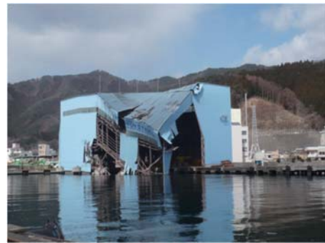
船舶衝突により損傷したと思われる全天候バース
