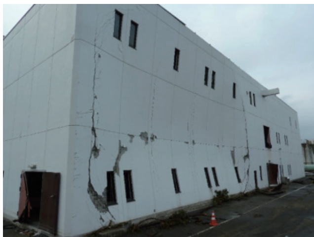
写真2 RC造外壁の面外変形被害
