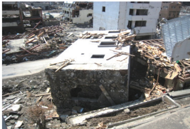
写真1 RC造建物の転倒被害
