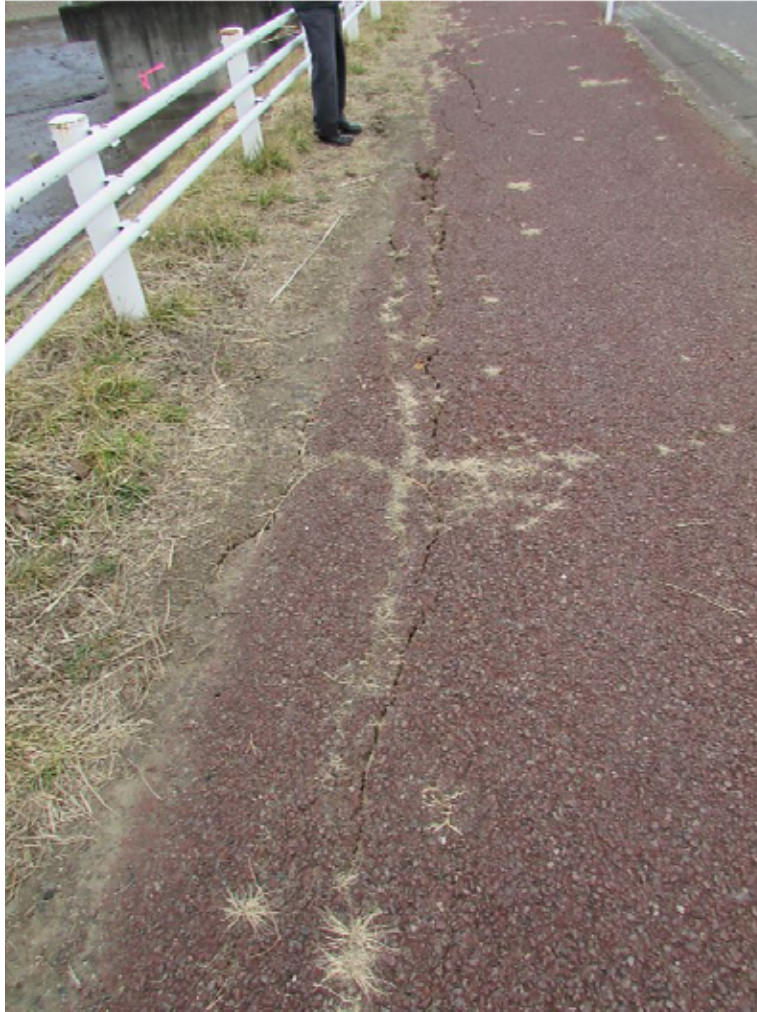
敷地東側の道路縦断亀裂
