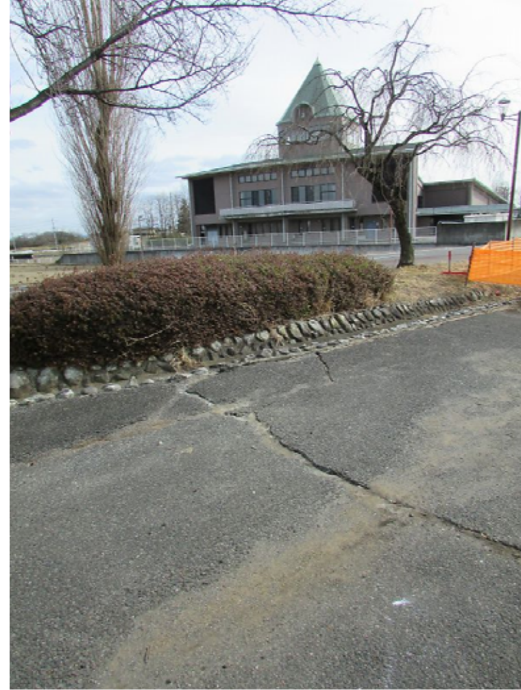
図書館前道路(北側)の横断亀裂 (奥が図書館)
