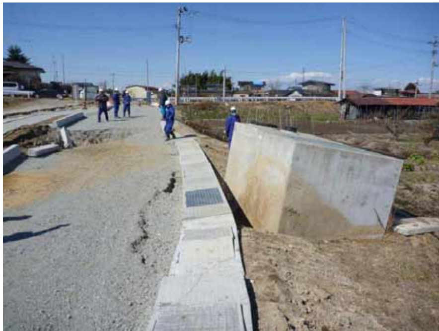
噴砂・排泥工の浮上・傾斜 (有吉ほか、2012)
