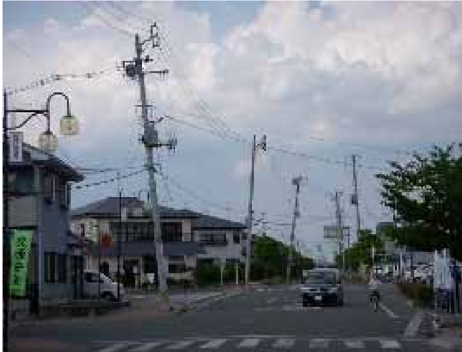
電柱傾斜・沈下 ( 37.251214, 140.346818 )
