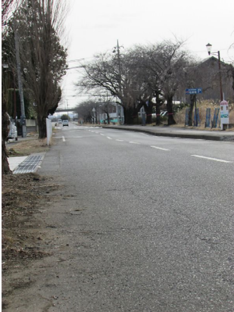
図書館前道路(南方を望む) の波打ち
