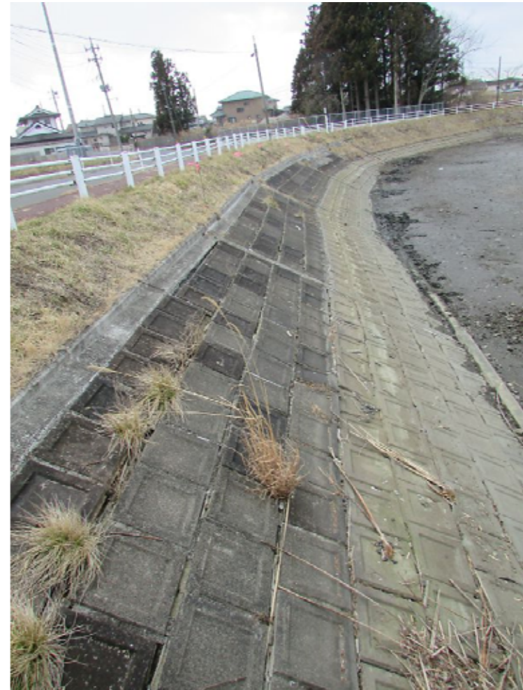
ため池堰堤のひび割れ(堰堤破損のため水は抜いたとのこと)
