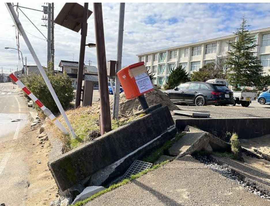
図62 内灘町西荒屋ハ6-54 西荒屋小学校 (36.678283N, 136.667953E, 方位角235.4328°)
