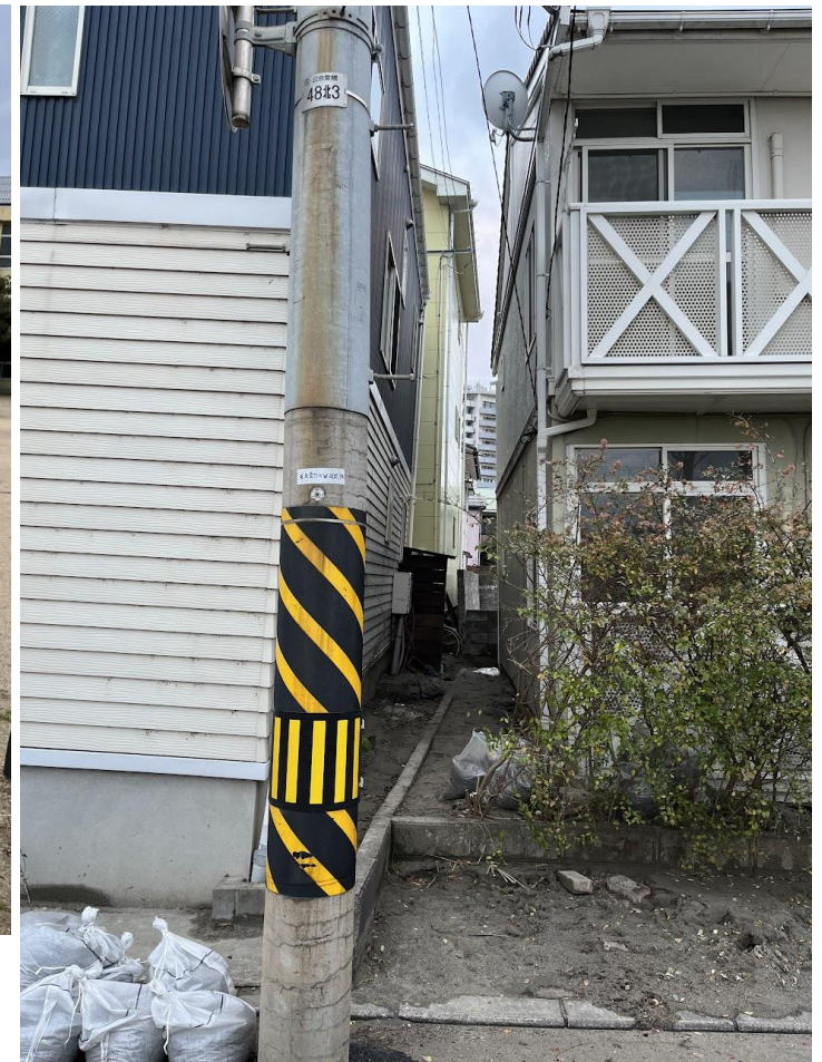
図10 新潟市中央区川岸町3-28-5 (37.908103, 139.023758E, 方位角231.595°) 噴砂と家屋の傾斜、電柱の沈下が確認された。1964年新潟地震では信濃川に平行な地割れが確認されている 5) 。
