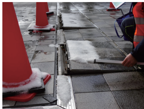
図8 床免震Exp.Jの損傷事例 (2)
