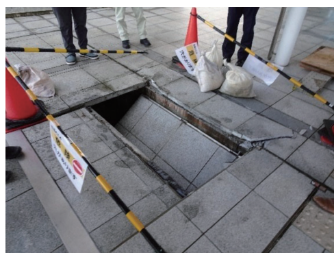
図7 床免震Exp.Jの損傷事例 (1)
