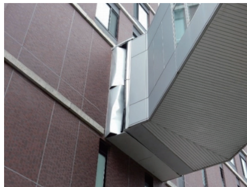
図3 本館に接続する免震Exp.Jパネルの損傷
