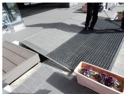
図4 液状化による地盤沈下で建物と段差が発生
