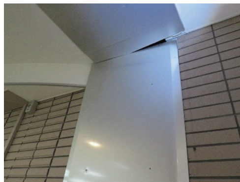
図9 壁、天井Exp.Jの損傷事例
