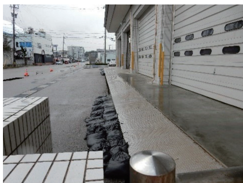
図6 地盤沈下による車庫入口の段差と土嚢
