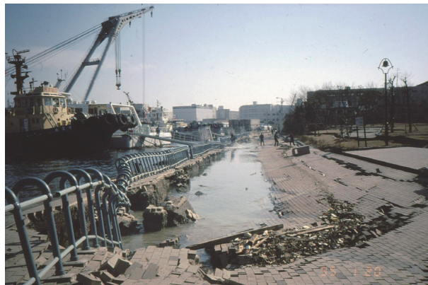
写真2 ポートアイランドの岸壁の被害状況
