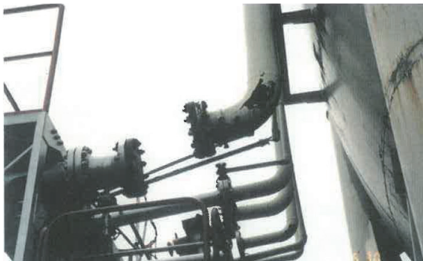
図3 配管接合部の損傷 (1)
