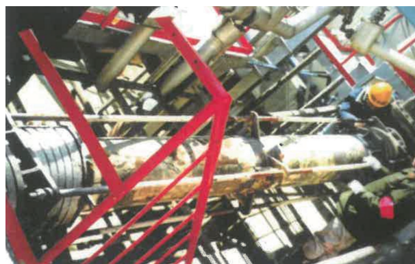
図1 LPガス漏洩した受払配管系と漏洩箇所 (1)
