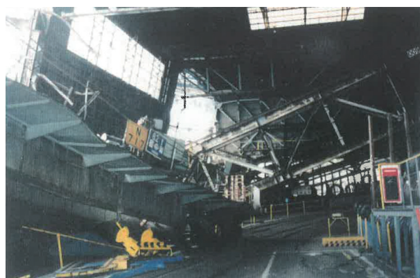
図6 建物損壊による天井クレーンの落下 (2)
