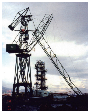
図7 ジブクレーンのジブ折損 (2)
