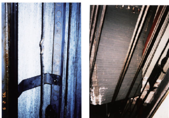
(a) ロープの損傷
