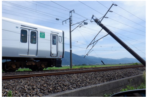
鹿児島本線の被害状況
