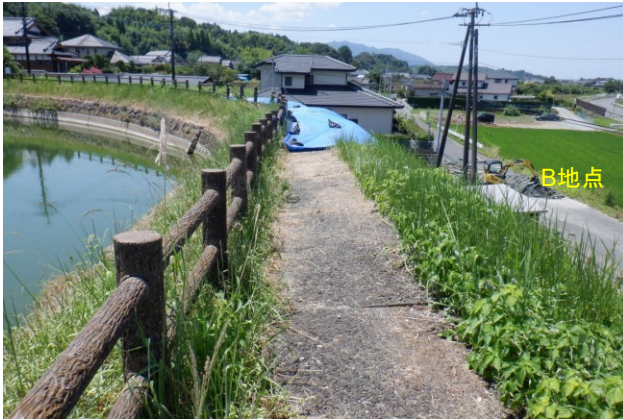
ため池堤体の一部のズレ
