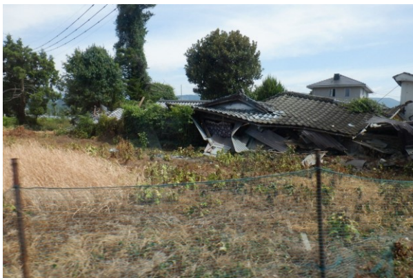
全壊した住宅
