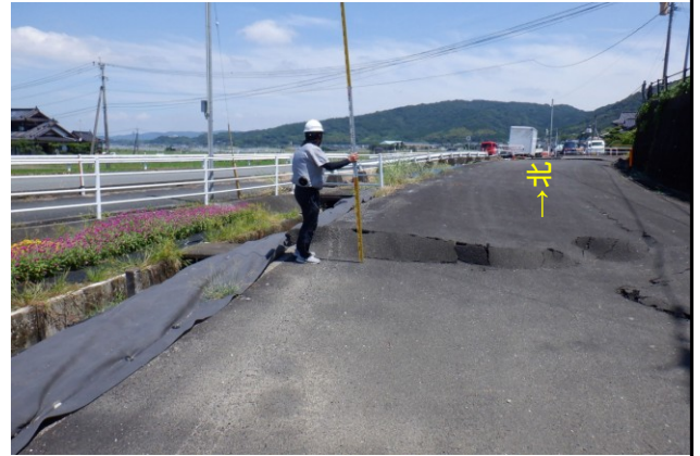
ため池の下の道路における舗装の突上げ
