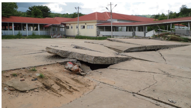
2025年ミャンマーのマンダレー地震に際して首都ネピドーで生じた右横ずれ断層
