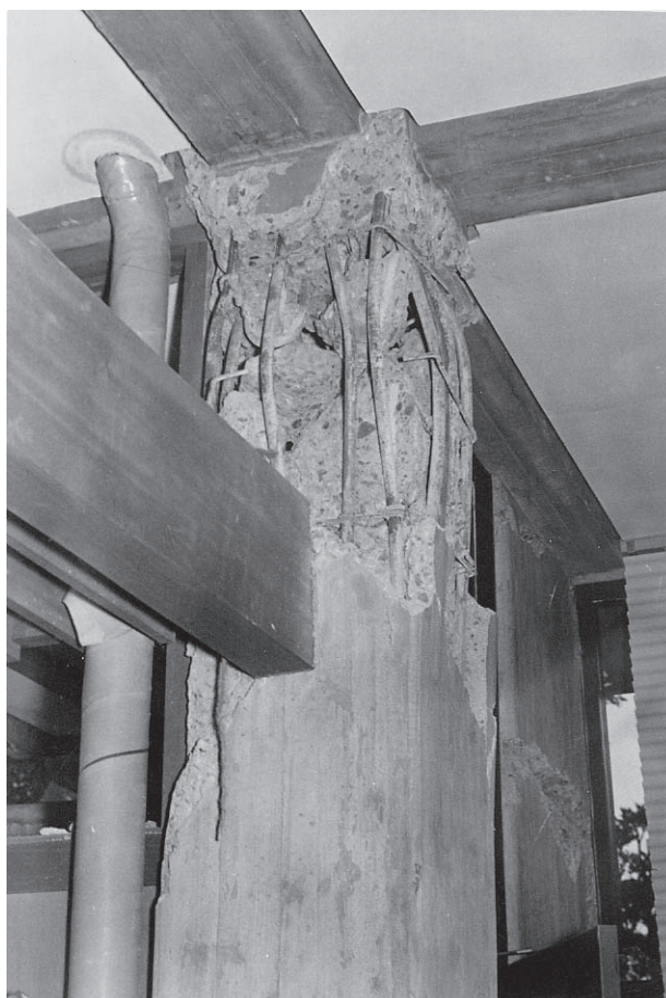
写真2 八戸図書館：柱の曲げ・せん断破壊
