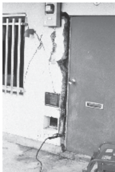
写真6 非構造壁のせん断破壊
