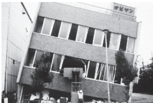
写真1 鉄筋コンクリート造3階建物の崩壊
