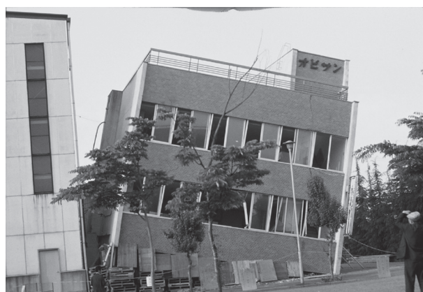
写真3 オビサンの建物。1階が倒壊している。
