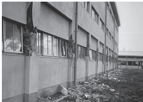
写真1 八戸高専：短柱のせん断破壊
