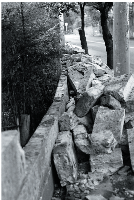
写真6 石垣の倒壊例
