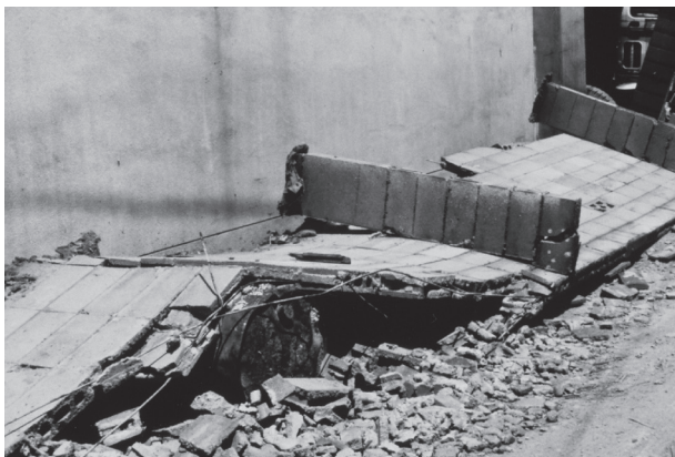
写真5 ブロック塀の倒壊例
