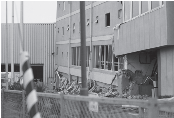
写真4 パロマの建物。1階が倒壊している。
