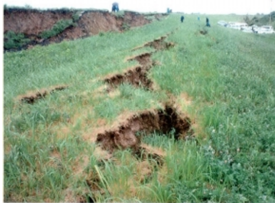
写真-1 鳴瀬川木間塚周辺における河川堤防の被害状況 (右岸側:国土交通省東北地方整備局北上川下流河川事務所提供)
