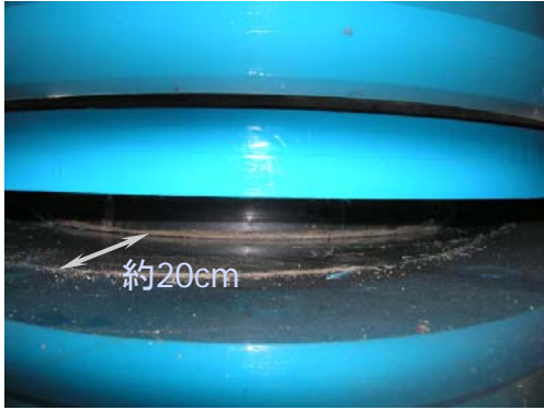
写真1 弾性すべり支承のすべり移動跡 (建築物A)
