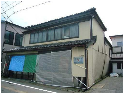
写真 1.15 全壊した木造建物
