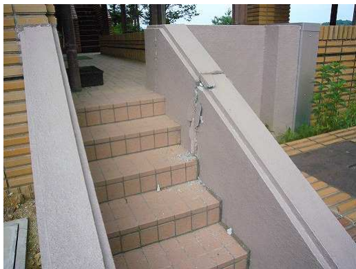
写真 15.3 外階段の損傷
