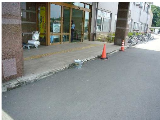
写真 9.3 いきいき館福祉センター入口の地盤の被害
