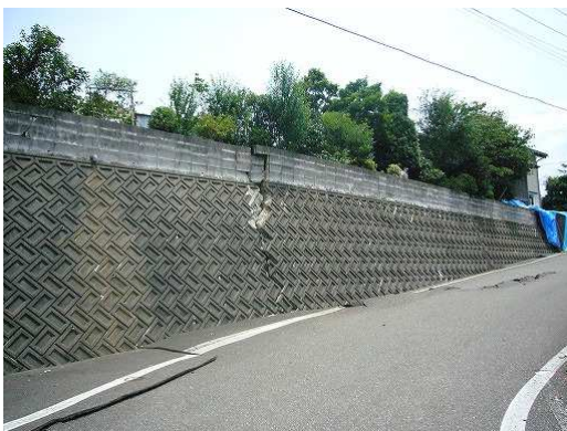
写真 9.13 石垣と地盤の被害
