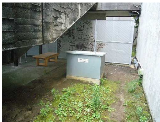
写真 1.4 震度計の設置状況
