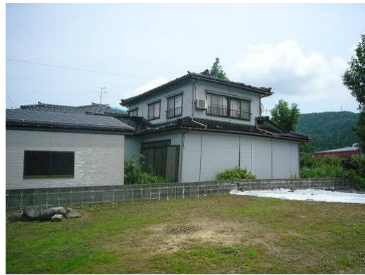
写真 9.10 地盤が変形し全壊した木造建物
