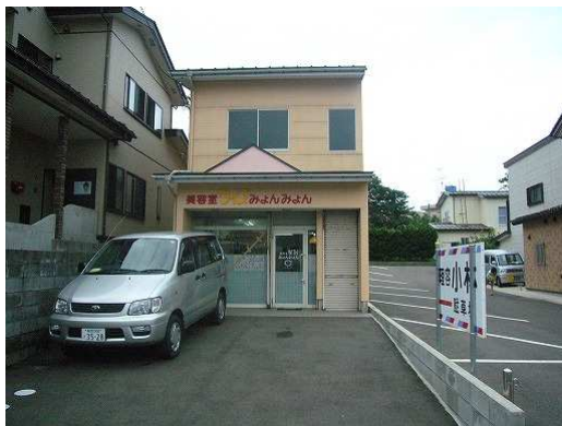
写真 2.9 ガラスの被害
