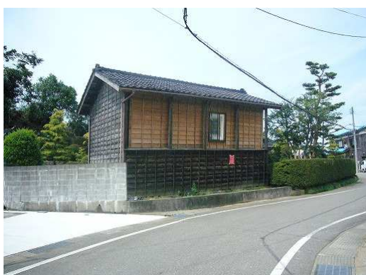
写真 10.9 全壊した木造倉庫
