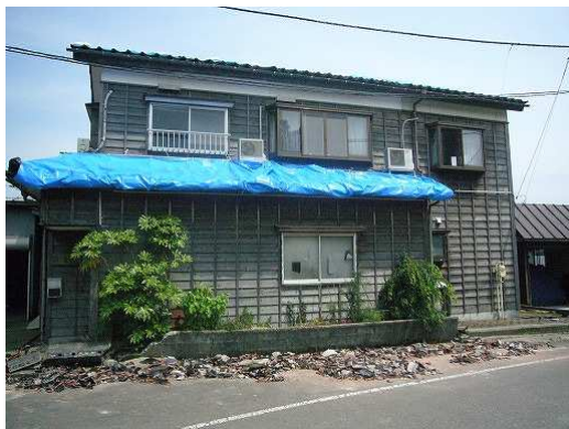
写真 10.13 屋根瓦に被害を受けた木造建物
