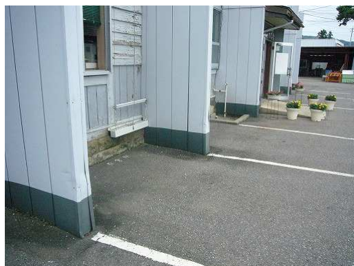
写真 16.4 補強されたと思われる部材のカバーの変形
