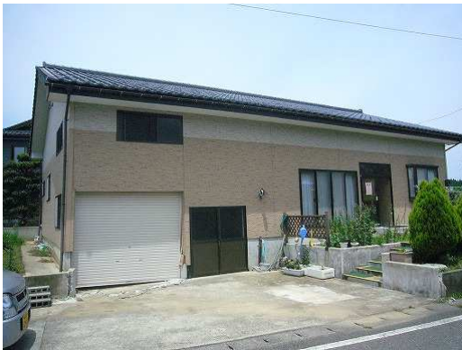
写真 9.11 車庫部分が変形した木造建物
