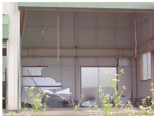
写真 11.10 倉庫の内装材の落下
