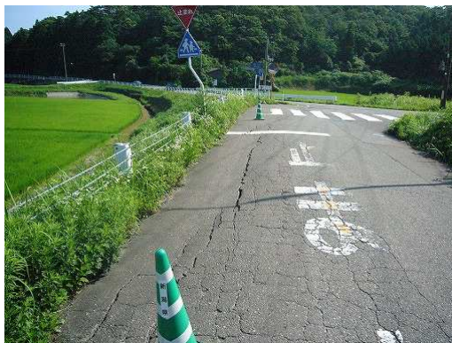
写真 7.6 道路のひび割れ
