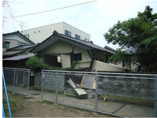
写真 1.14 全壊した木造建物
