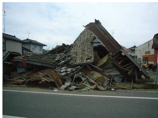
写真 1.18 倒壊した倉庫
