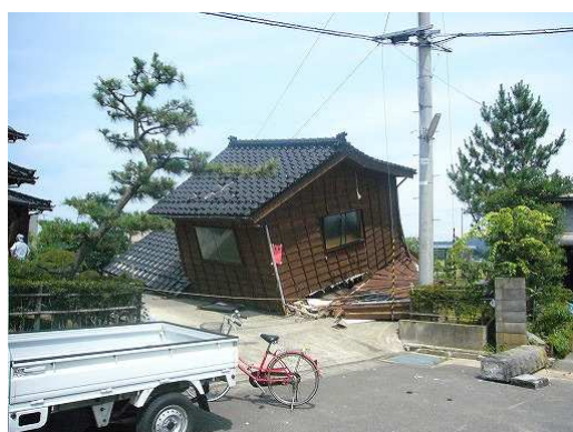
写真 10.10 全壊した木造倉庫
