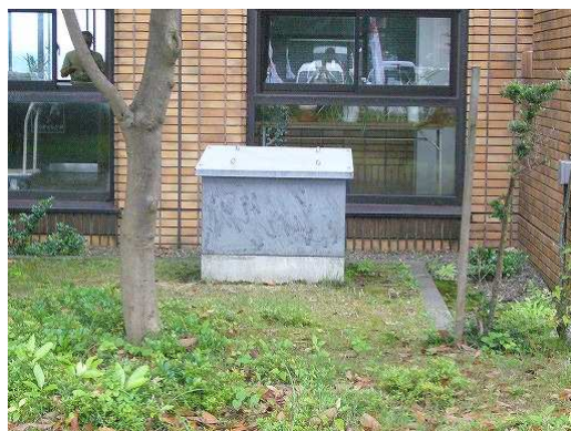
写真 2.2 震度計の設置状況
