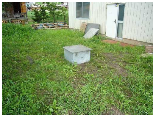
写真 16.2 震度計の設置状況
