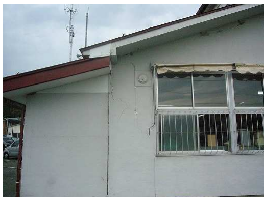
写真 16.3 壁の軽微なひび割れ
