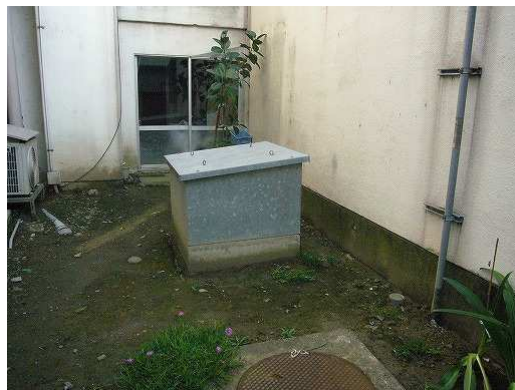
写真 6.2 震度計の設置状況
