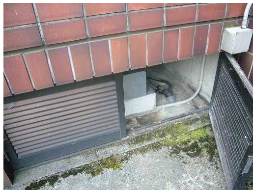
写真 12.2 震度計の設置状況
