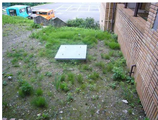
写真 15.2 震度計の設置状況
