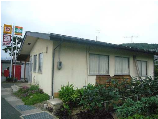
写真 16.11 外装材の落下が見られる木造建物
