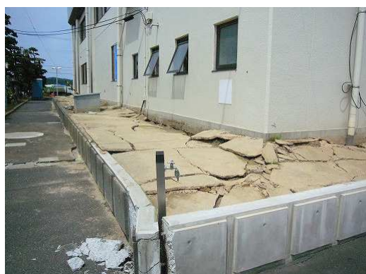
写真 10.3 震度計が設置された地盤の被害
