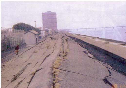
写真1 淀川河口部左岸西島の堤防崩壊 8)
